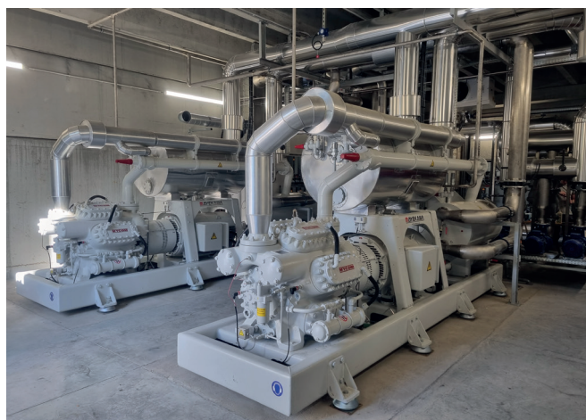
Chiller Fugu instalado en Francia
