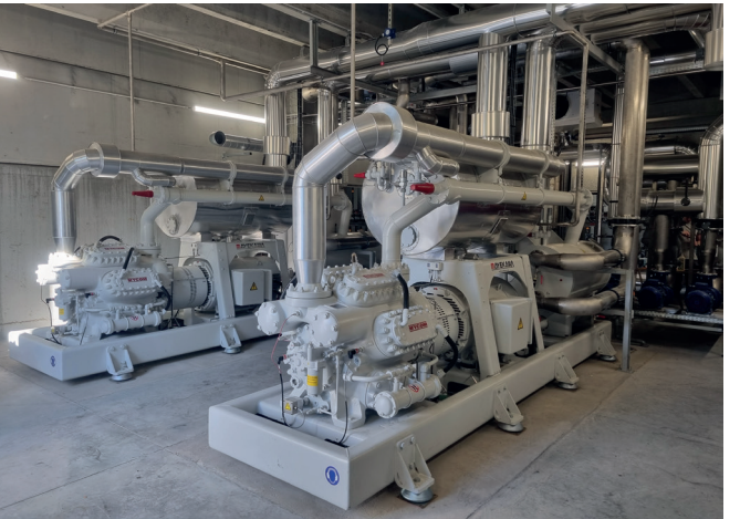
Chiller Fugu instalado en Francia
